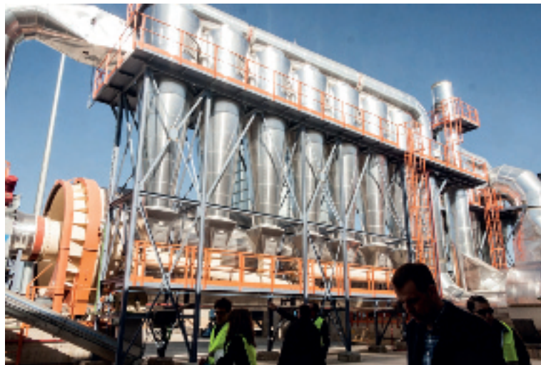
Filtros de mangas de Recalor. Detrás, el trommel de secado de la astilla forestal
