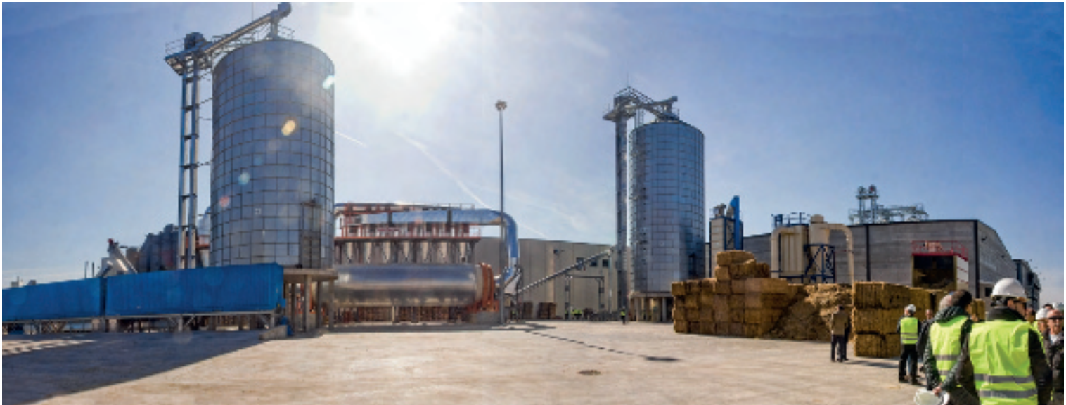
Vista general desde la campa de acopio. Silos de almacenamiento, filtros de mangas y tromel de secado de astilla, instalados por Recalor
