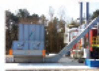
SISTEMAS DE ALIMENTACION A CALDERA
