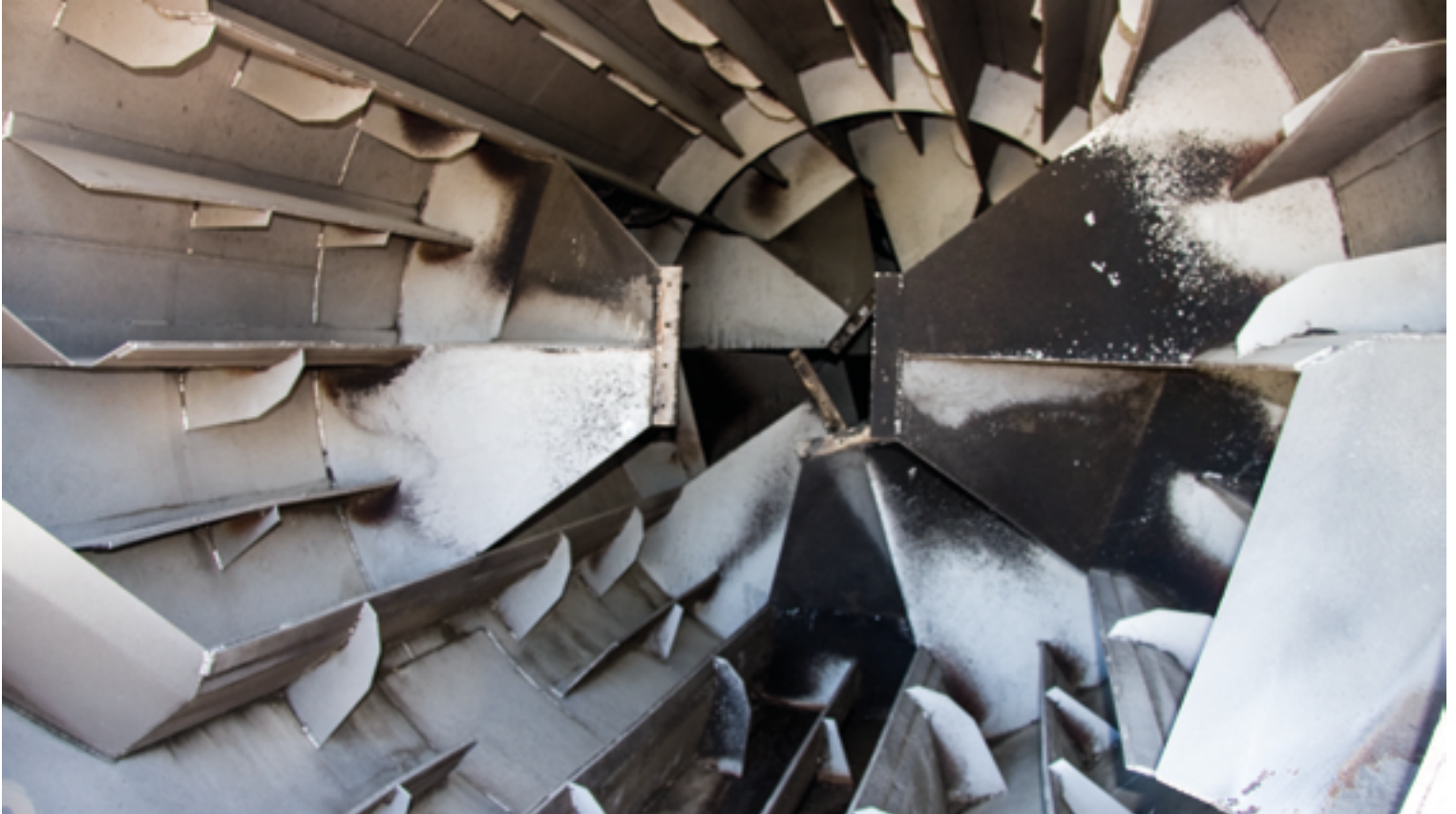
En la imagen, interior de un secadero rotativo con sistema Multivoltteo.
