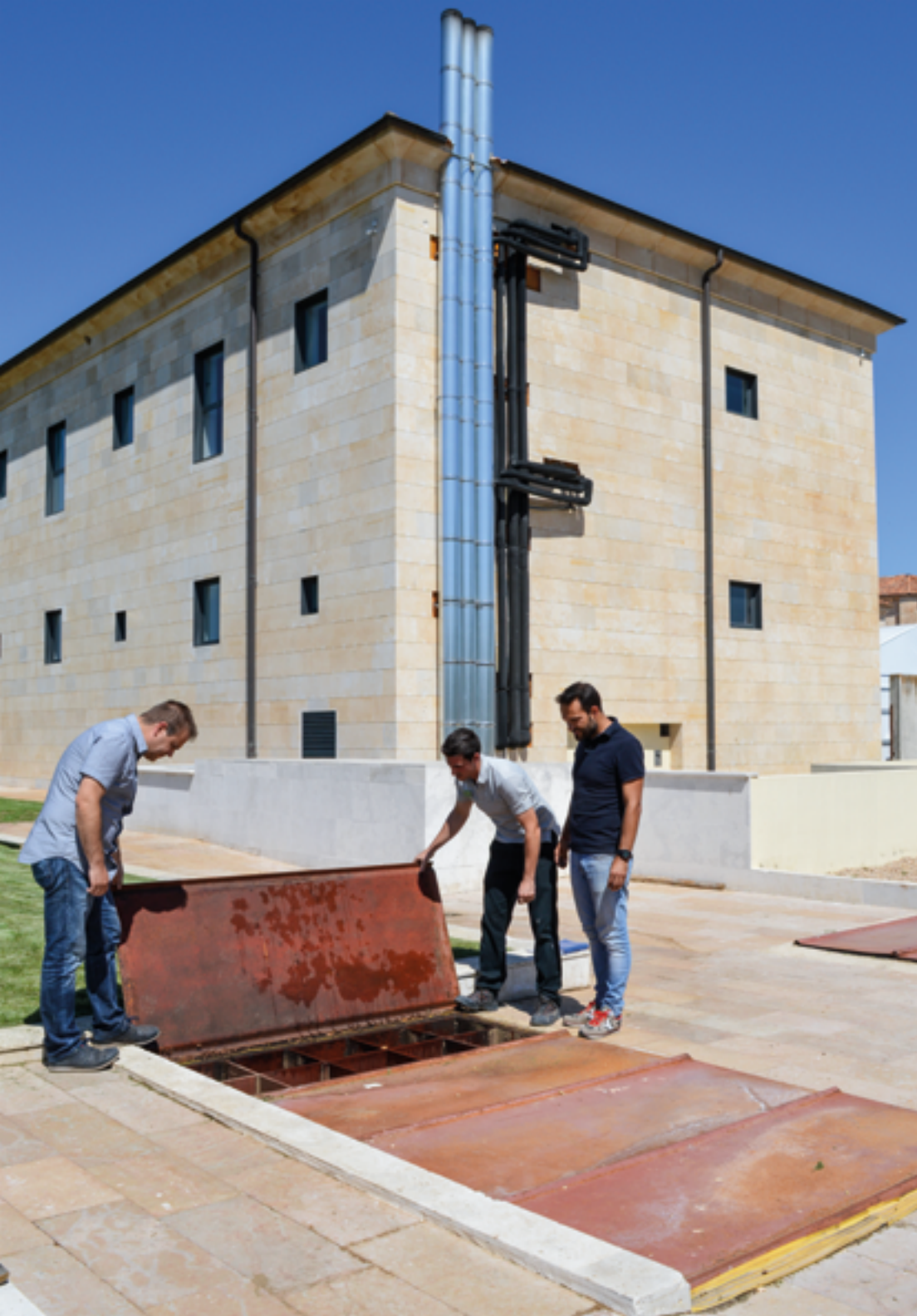
Silo de biomasa subterráneo
