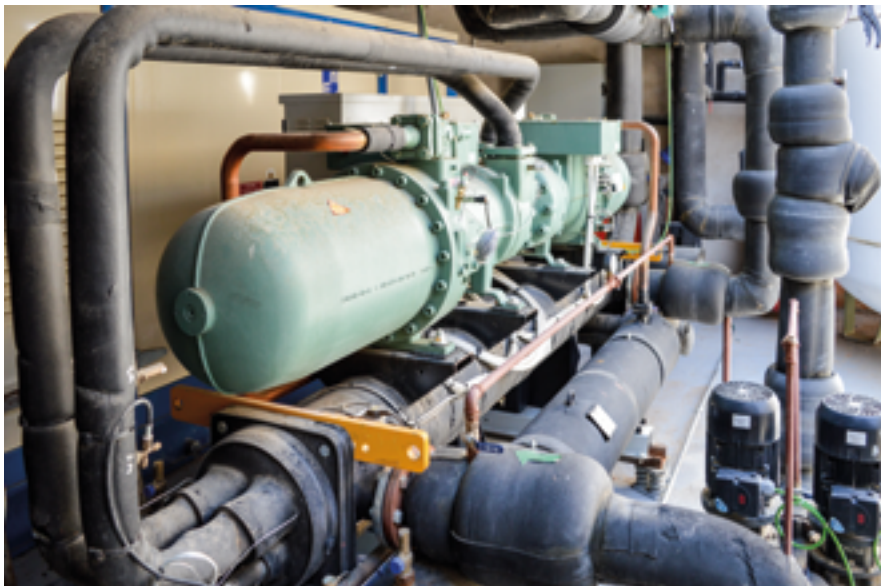
Sistema de generación de frío con geotermia
