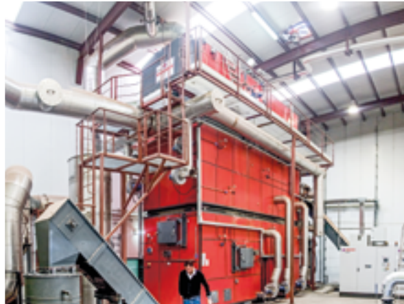
Izquierda, Colectores en una instalación de biomasa para piscina ejecuta por FORESA. Derecha, caldera de biomasa para producir vapor en industria, instalada por IMARTEC
