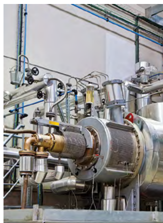
Planta piloto de torrefacción del BIO2C de CENER
