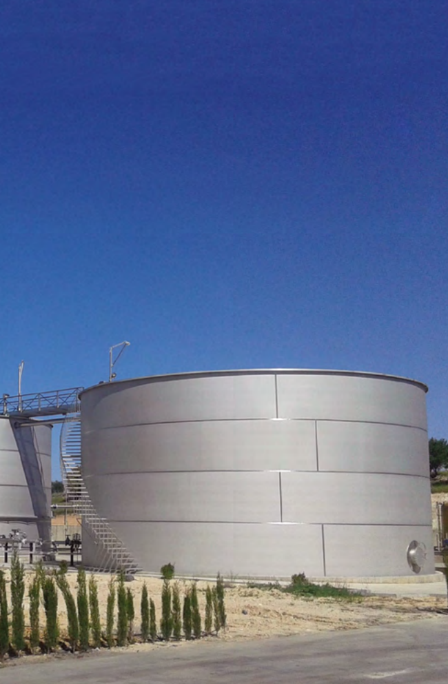
Reactor anaerobio con tecnología IC para producción de biogás en las instalaciones de Daimiel
